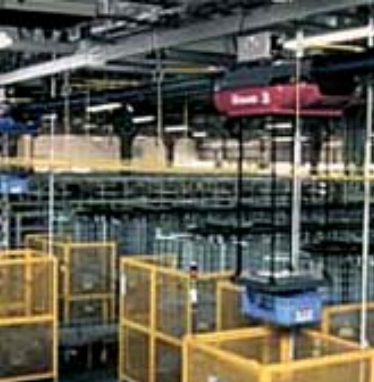
天井搬送システム
